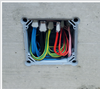
Scatola di derivazione aperta in un garage sotterraneo.
